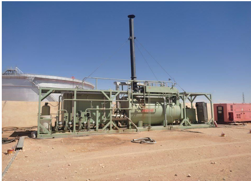
Figure III.8: Unité de chauffage
