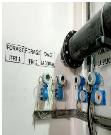
Débit mètre des forages
