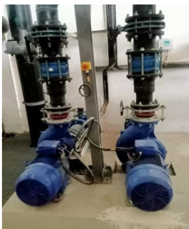
Pompe de Lavage de filtre à Sable
