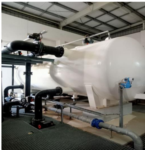
Figure III.03: Filtre à sable.
