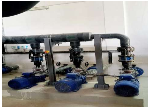
Figure III.4 : Pompes d'alimentation des filtres à sable
