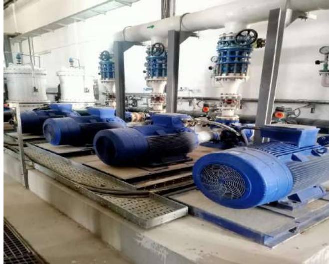
Figure III.11 : Pompes d'alimentation haut pression
