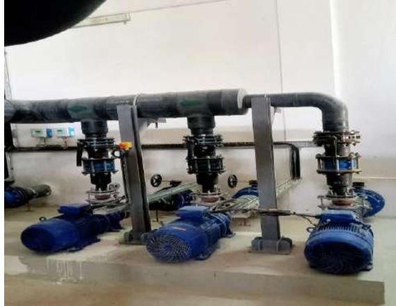
Figure III.8 : Pompes d'alimentation basse pression
