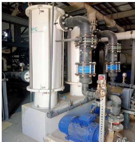
Figure III.13 : Filtre à cartouche nettoyage
