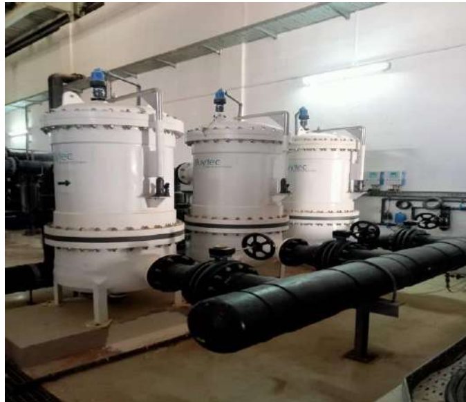
Figure III.10 : les Filtres à cartouches de la station de IFRI GARA S5
