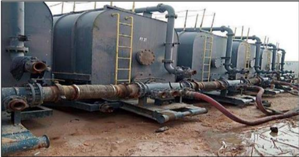
Figure II.2 : Réservoir d'eau (FRAC TANK). [7]
