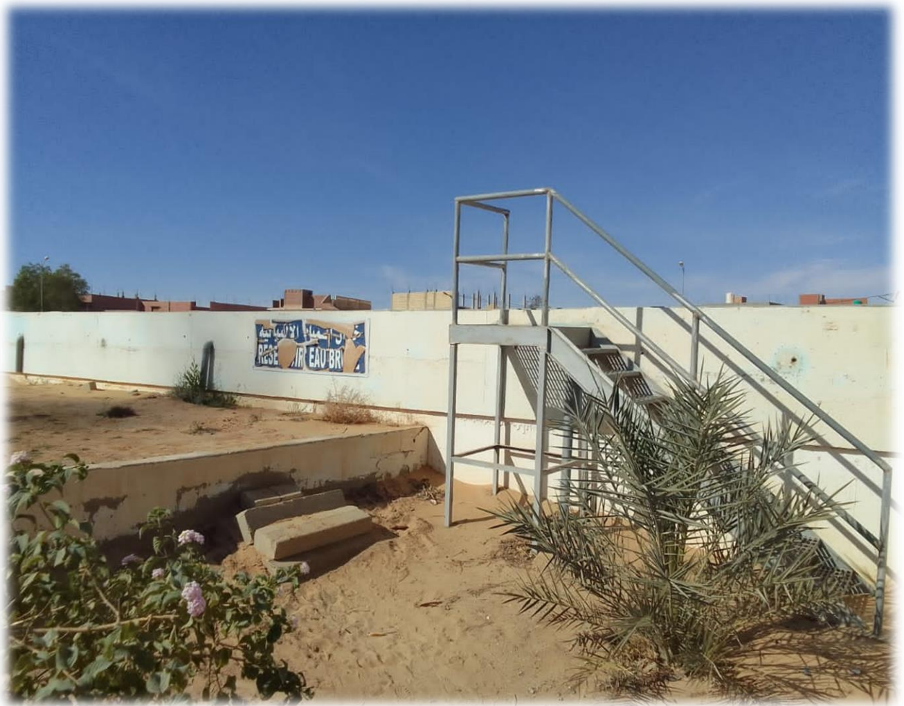
Image 4 : Réservoir d'eau albanaise
