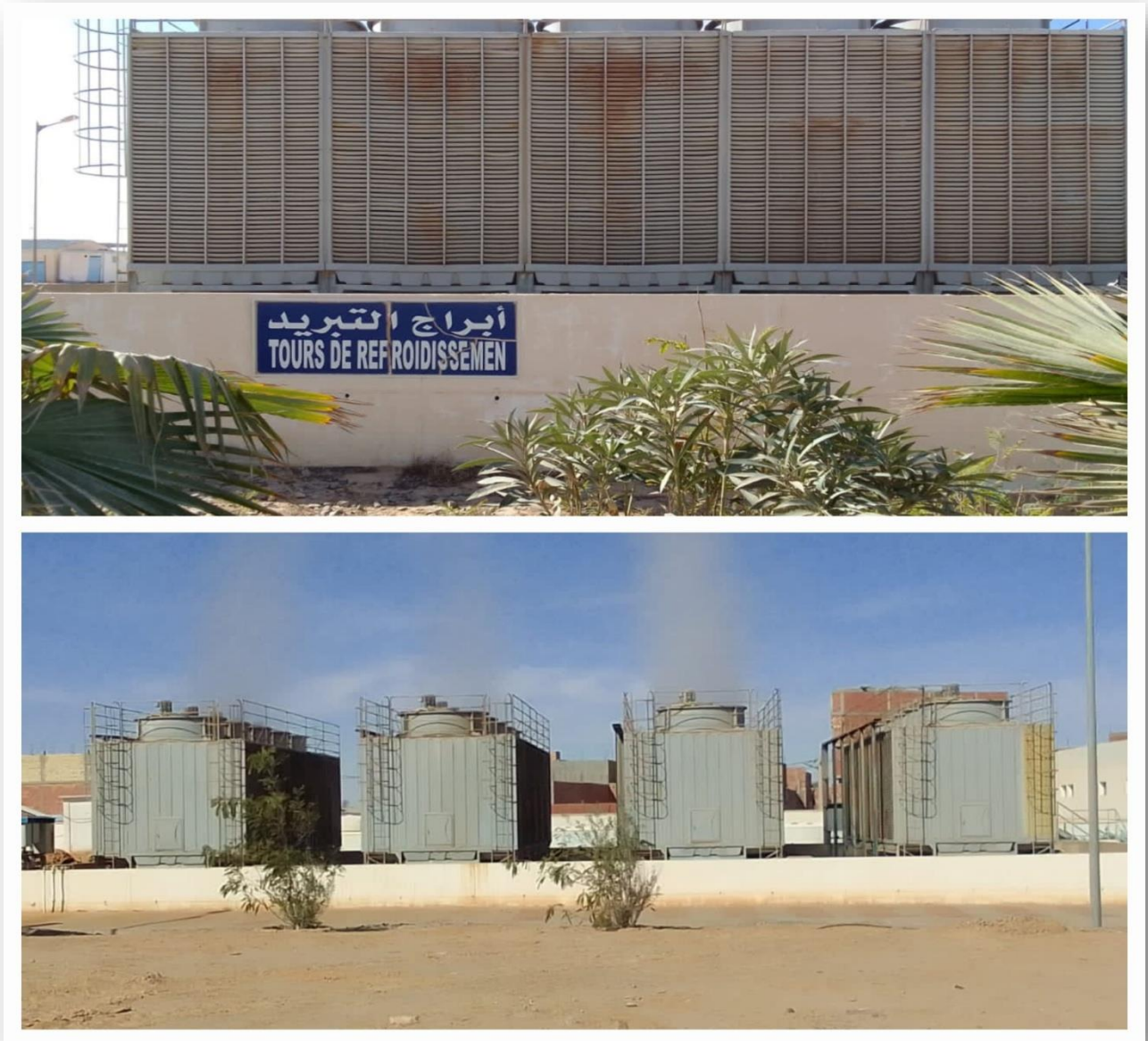
Image 3 : Tours de Refroidissement
