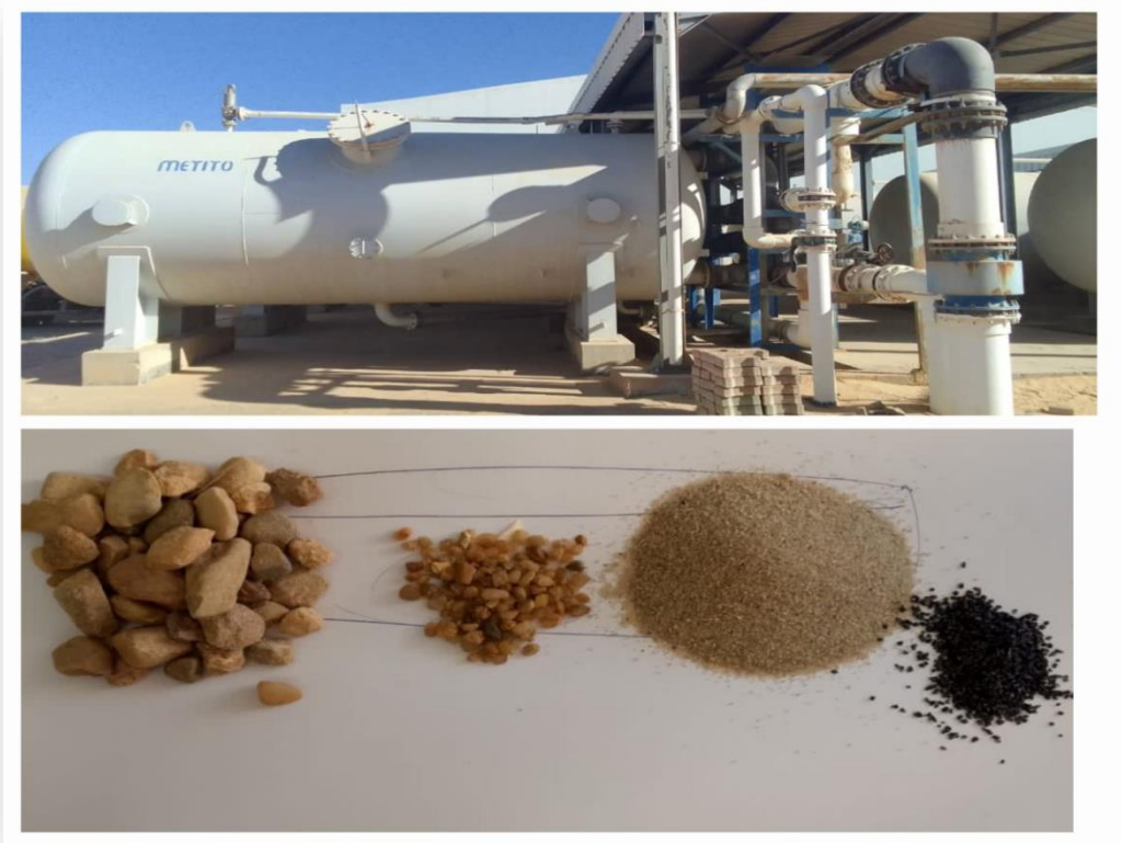
Image 6 : Filtres à Sable
