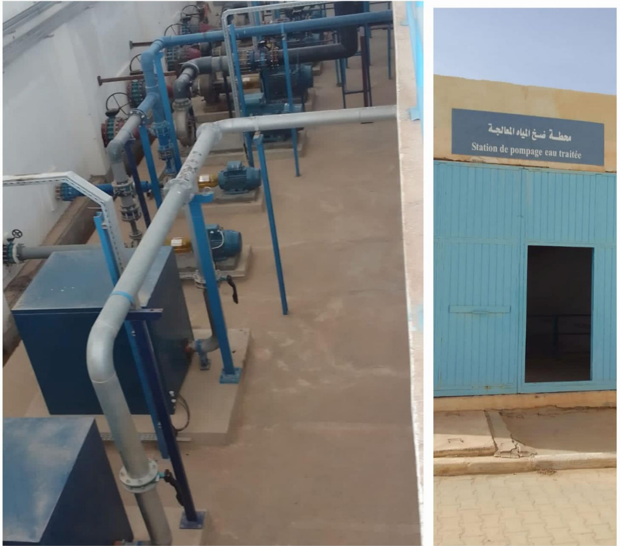
Image 5 : Station de pompage eau Traitée
