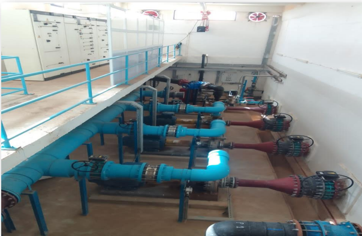
Image 11 : Station de pompage de distribution
