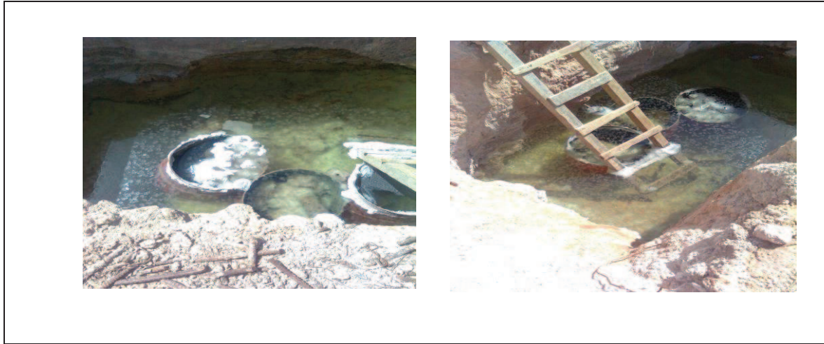
Photo (IV-2): Formation des cristaux dans la fouille et sur les éprouvettes en béton.
