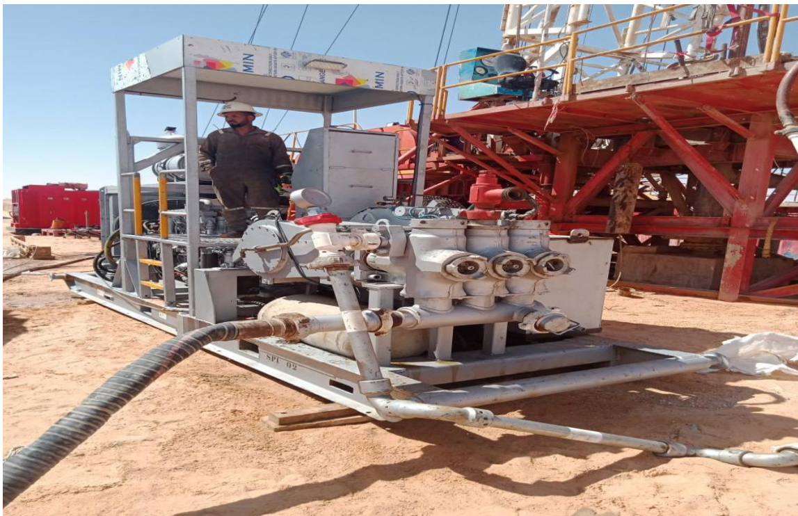
Figure 27: La pompe à boue triplex RL3NB-1300D.
