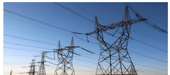
Figure I-3 : ligne électrique aérienne
