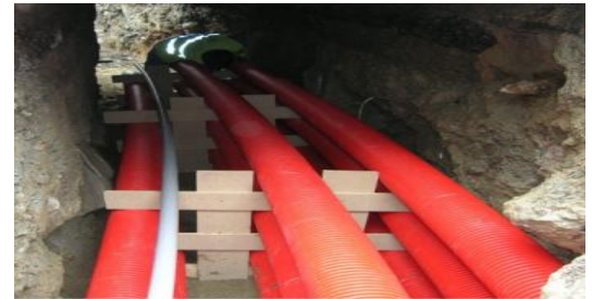
Figure I-5 : Ligne électrique souterraine
