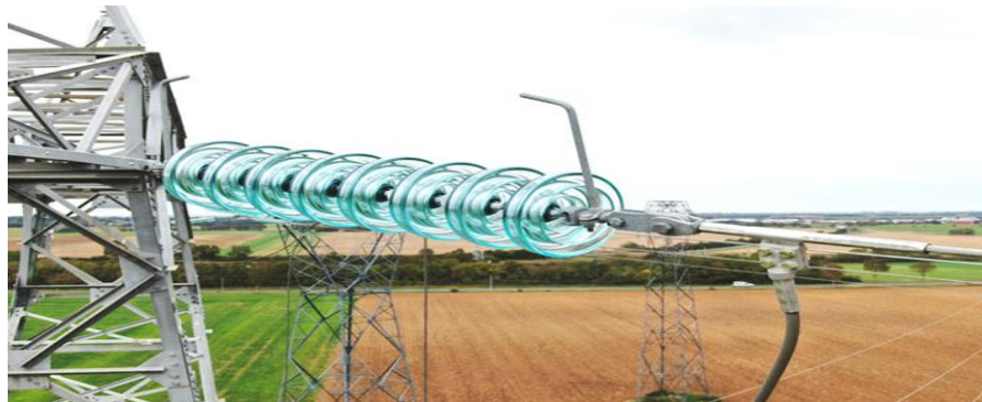
Figure I-13 : Isolateur d'une ligne haut tension.
