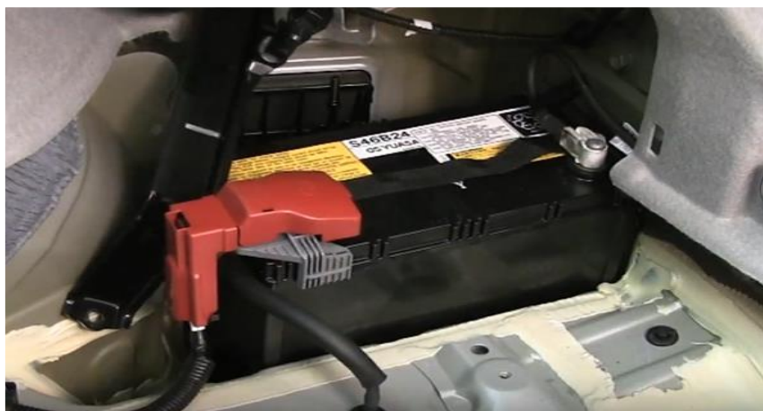
Figure II - 2 : Batterie Lithium-ion (Li-ion) à haute tension
