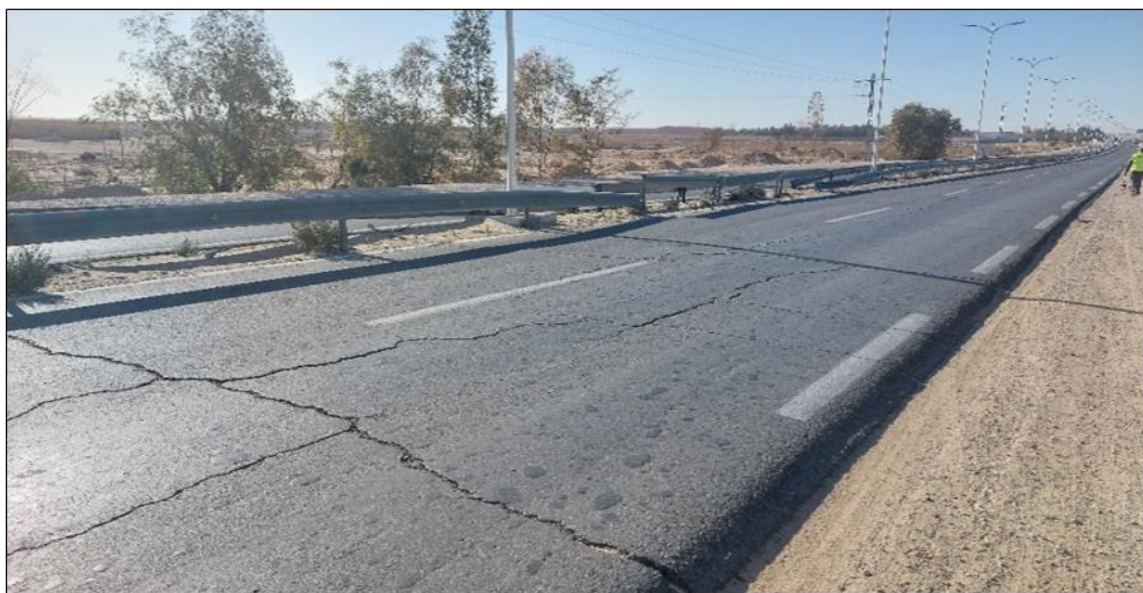
Image I.1: Fissures longitudinales et transversales (PK 542+600)
