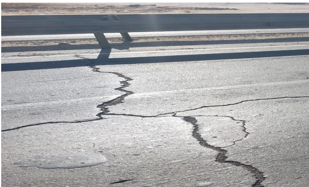
Fissures : arrachements, épaufrures nid de poules Images de Relevé visuel de tracé
