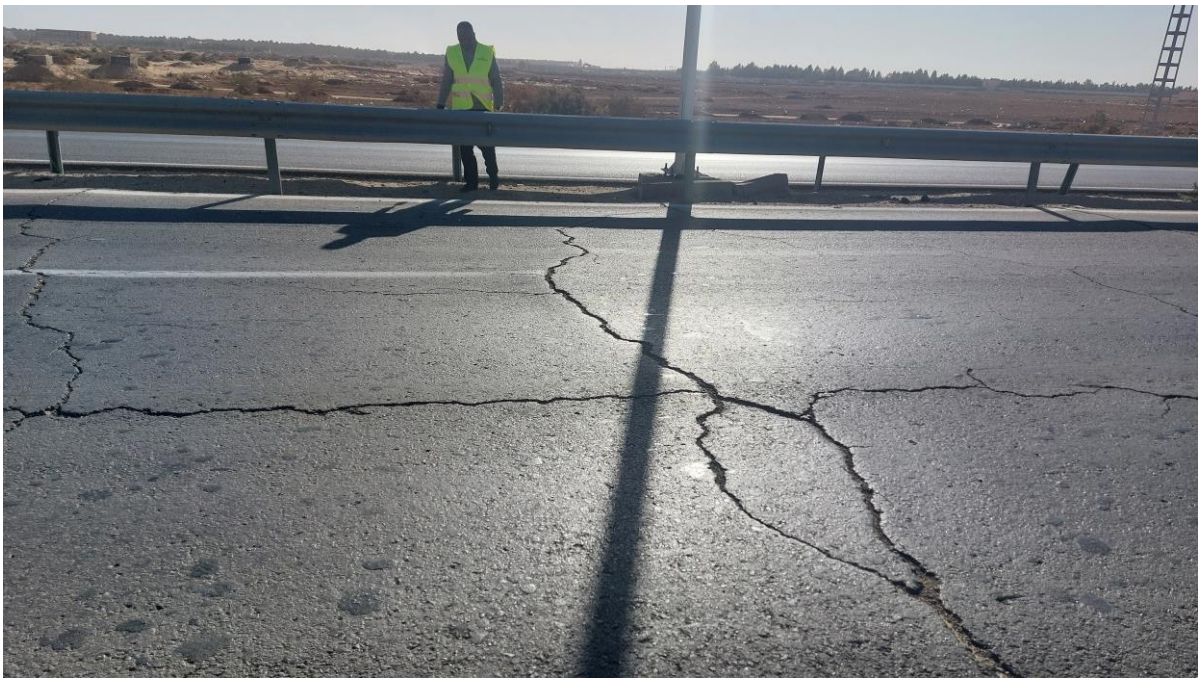
Fissures transversales, longitudinales et joint.
