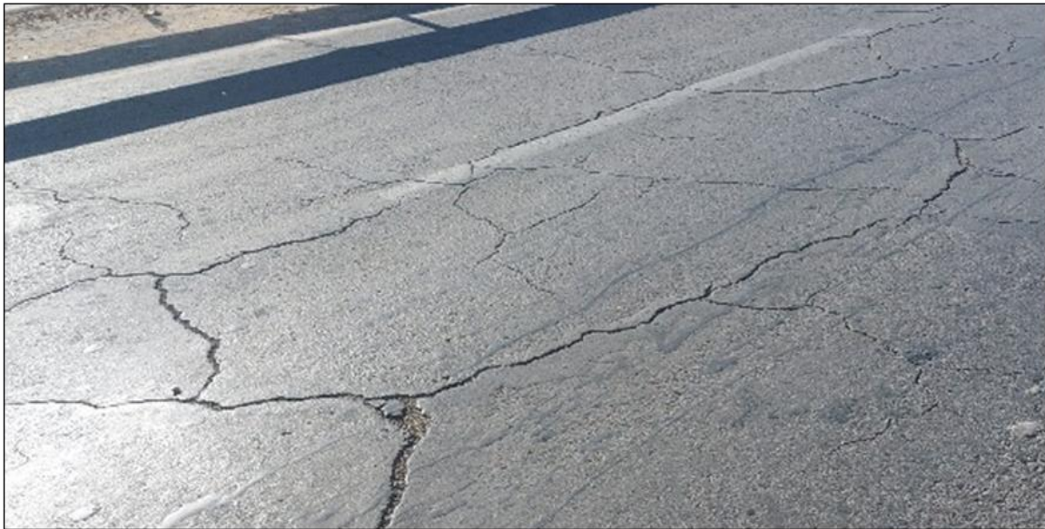
Image I.2: Fissures de fatigue (peau de crocodile) (PK 543+300)
