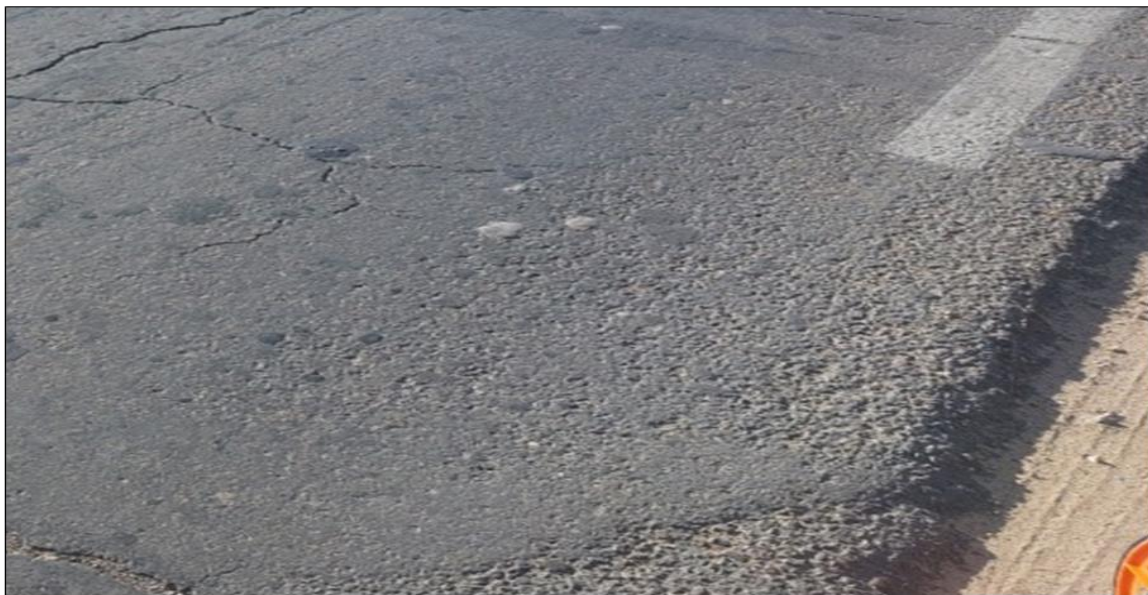
Image I.3: Arrachements au PK 542+800
