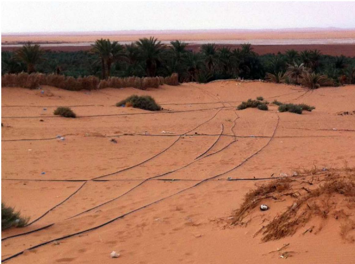
Figure 34. Réseau d'eau potable détourné pour l'irrigation des jardins à Tilouline (Hadeid et al. 2018)
