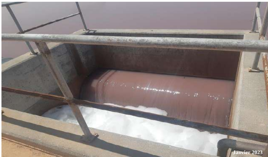
Figure 16. Bassin de sortie des eaux épurées (Sortie).
