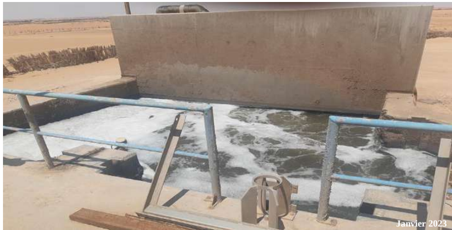
Figure 15. Bassin de collecte des eaux usées (Entrée).
