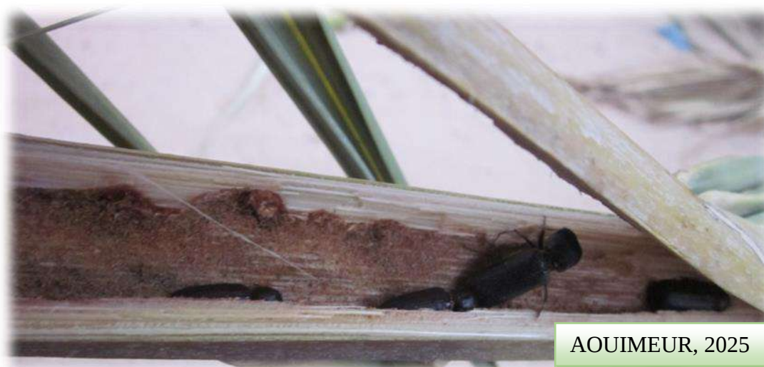
Fig. 52 – Galerie causée par l' Apaté monachus au niveau du palme
