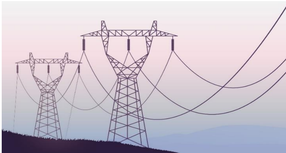
Figure II-6: Conducteurs des lignes aériennes entre pylônes.
