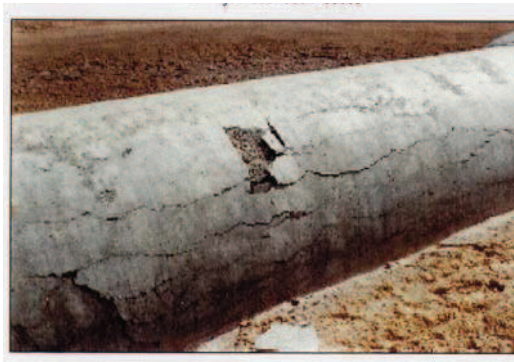
Figure (I-1) : Photo d'une canalisation dégradée.
