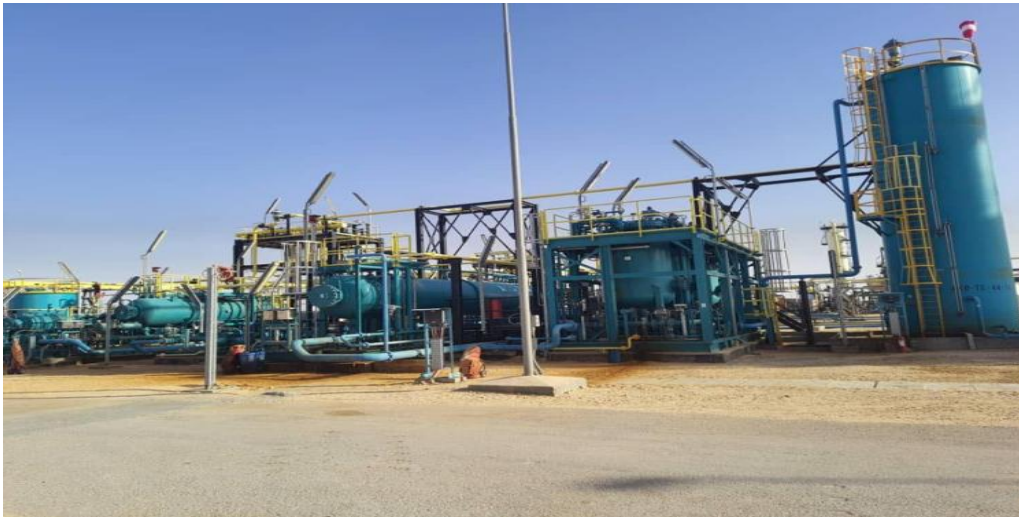
الشكل (II-02): وحدة معالجة المياه البترولية UTBS من شركة EXPRO.
