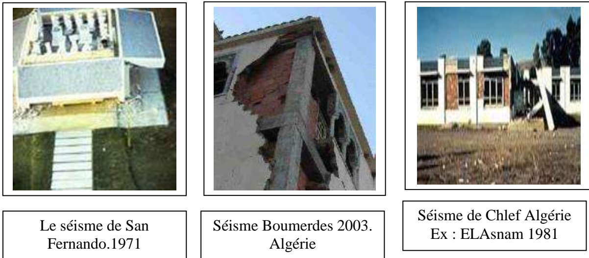
Figure I.23 : Effondrement de la structure causée par la mauvaise conception des porte-à-faux et la mauvaise fixation des éléments de la façade [21, 24]
