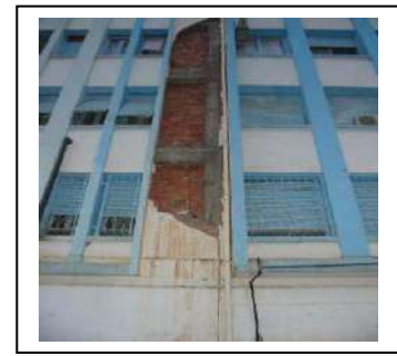
Joint de dilatation Boumerdès 2003.
