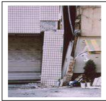
Joint parasismique trop étroite [24].
