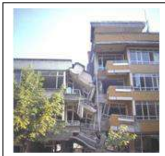
Joint parasismique trop étroite [24].
