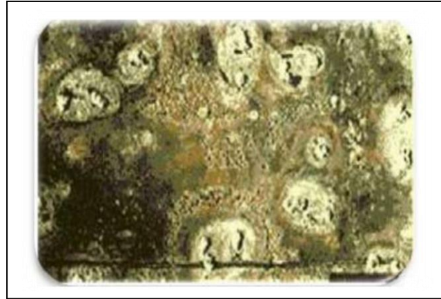
الشكل (I-6): التآكل النقري
