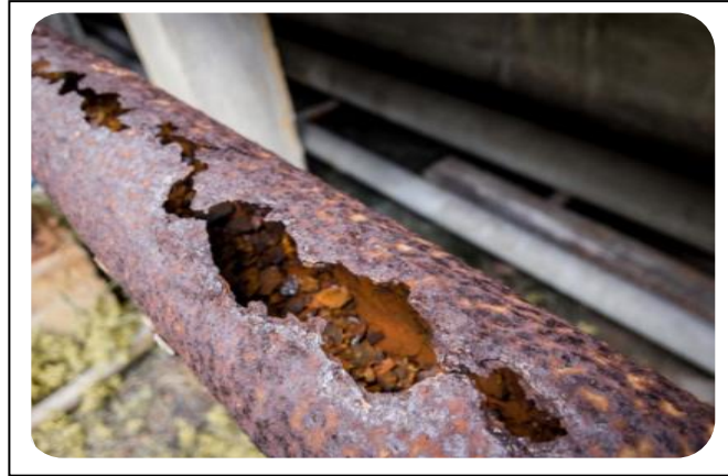
الشكل (I-1): صورة لأنبوب متآكل
