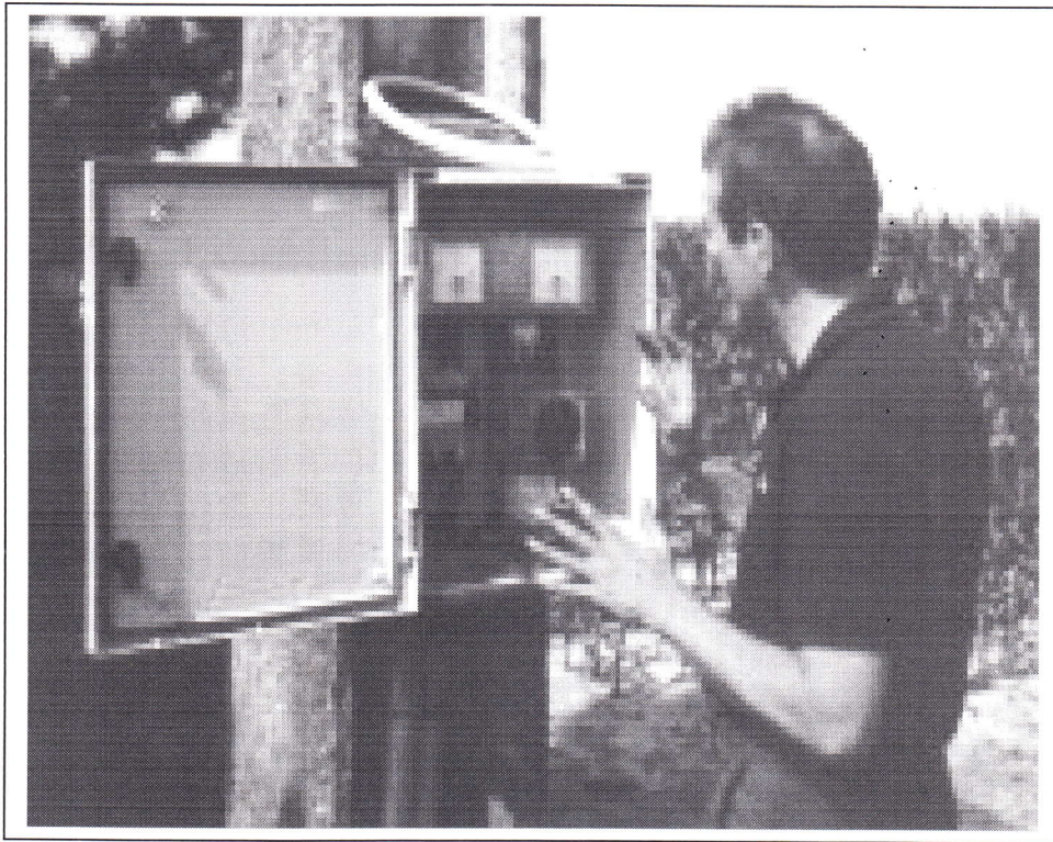
Fig II.9 : poste de soutirage.
