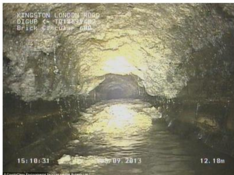
Figure III.03: Accumulation de graisses et huiles (FOG) dans le réseau d'égouts[123].
