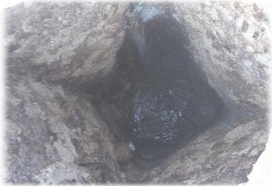
Figure II.09: Dégradation du béton d'un regard dans la cité kodia.
