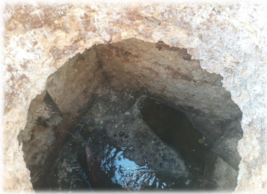
Figure II.08: Dégradation du béton et corrosion d'armatures d'un regard dans la cité lala mana Témacine.
