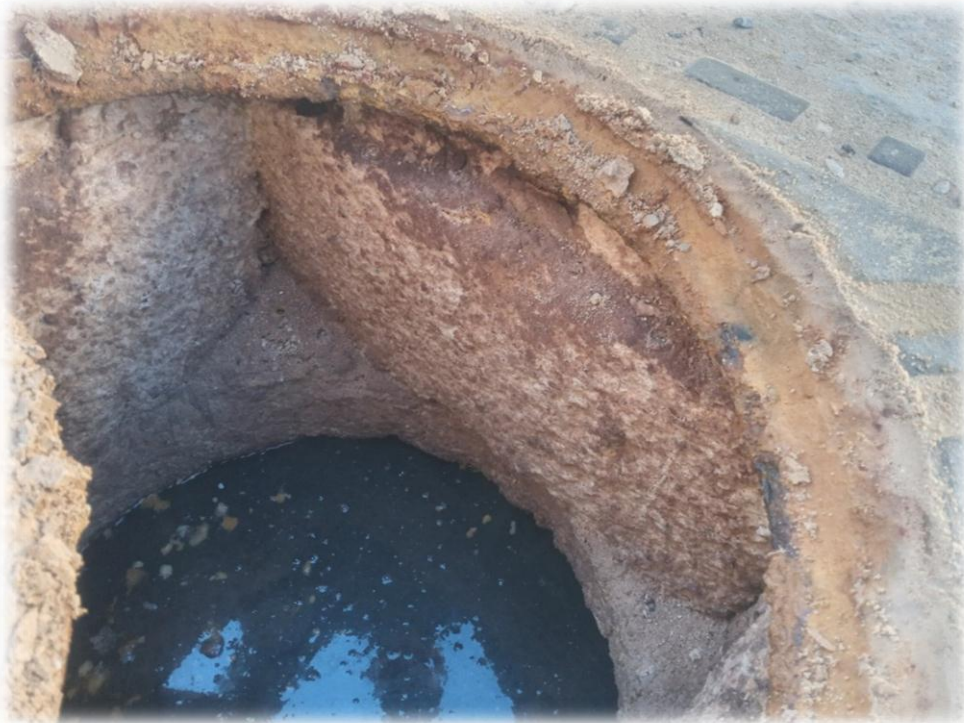
Figure II.07: Dégradation du béton d'un regard dans la cité Bohor.
