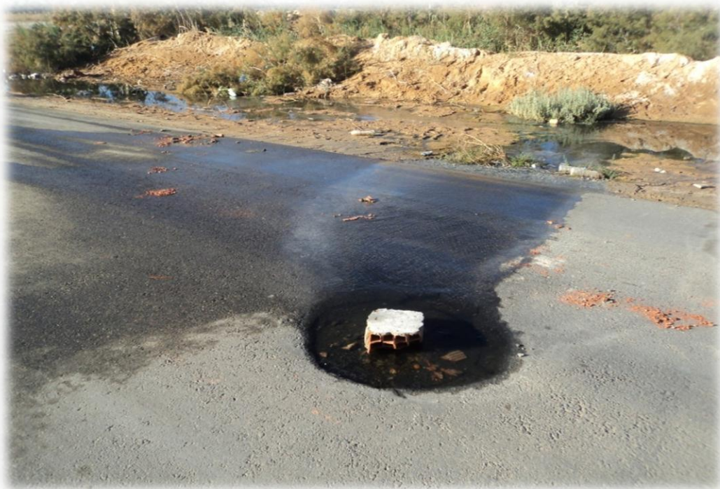
Figure II.02: Inondation de réseau d'assainissement dans le collecteur principal cité bohor.
