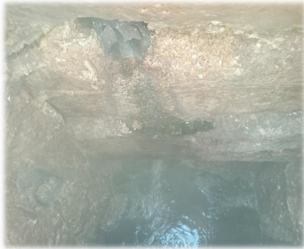
Figure II.03: Branchement mal placé dans un regard dans la cité tamalahat.
