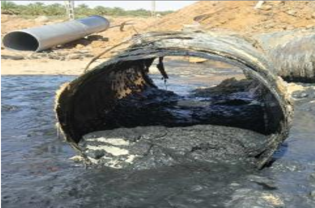
Figure II.01: Formation de bouchon dans une conduite dans la cité bohor.
