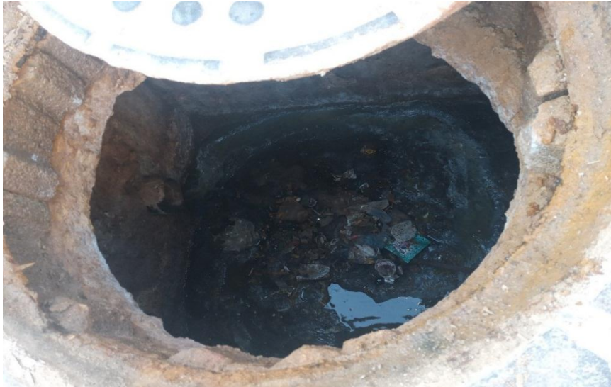
Figure III.04: Rejet des déchets dans un regard dans la cité zaouia Tedjania à Témacine.
