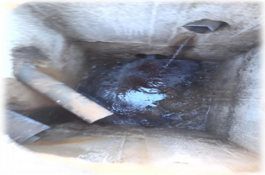
Figure II.04:Regard dégradé dans la cité elmanar.
