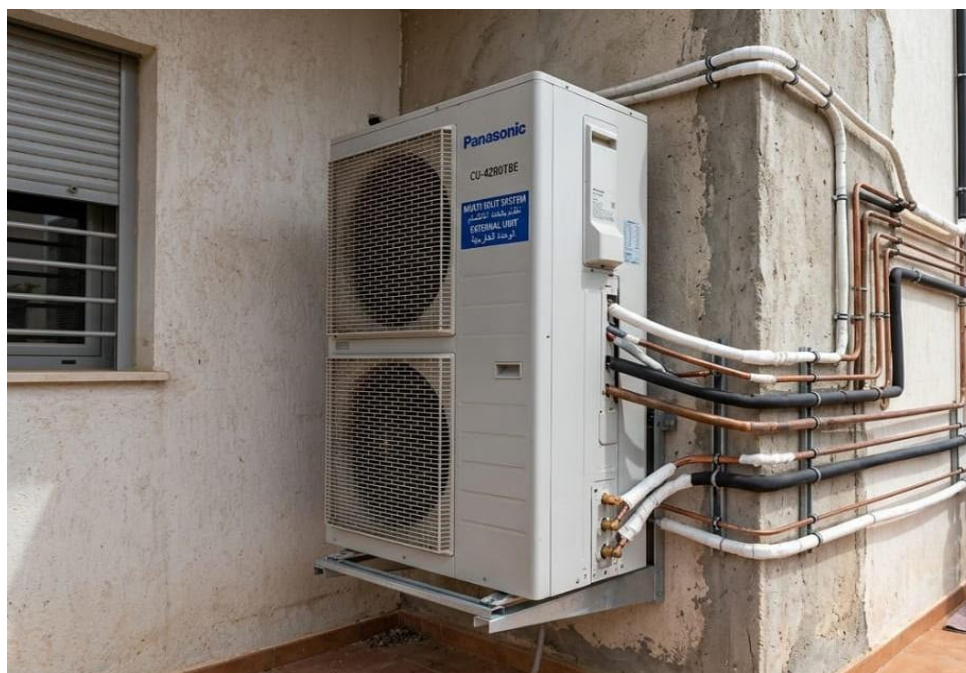
Figure III.1 : Nouvelle unité extérieure
