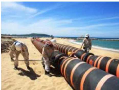
Transfert des hydrocarbures
