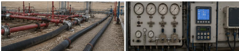
الشكل : III - 06 : خطوط الضخ وأجهزة المراقبة .
