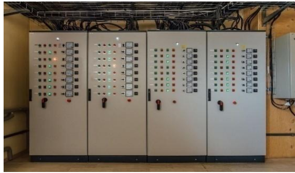
الشكل II- 25: لوحات التحكم الكهربائية.
