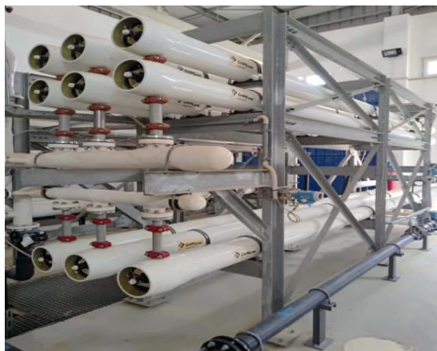
Figure II.16 : Unité d'osmose inverse.
