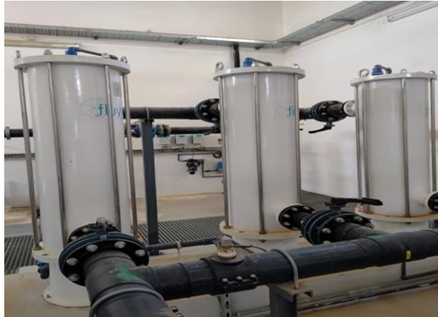
Figure II.15 : Les filtres à cartouches.
