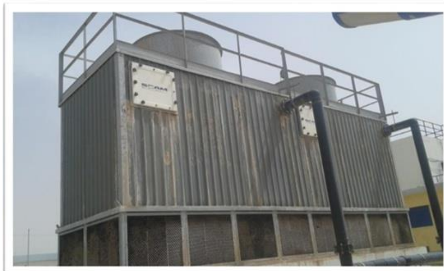
Figure II.II. 26 : Refroidisseur de la station de Ziaina (S6).
