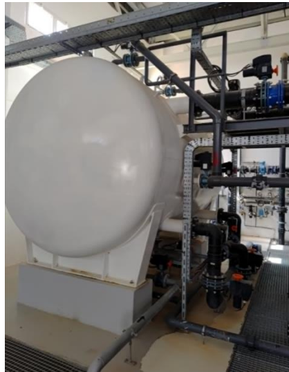
Figure II.13 : Ligne de filtre à sable.
