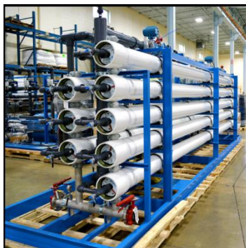
Figure I. 3 : Système industriel de nanofiltration [3].
