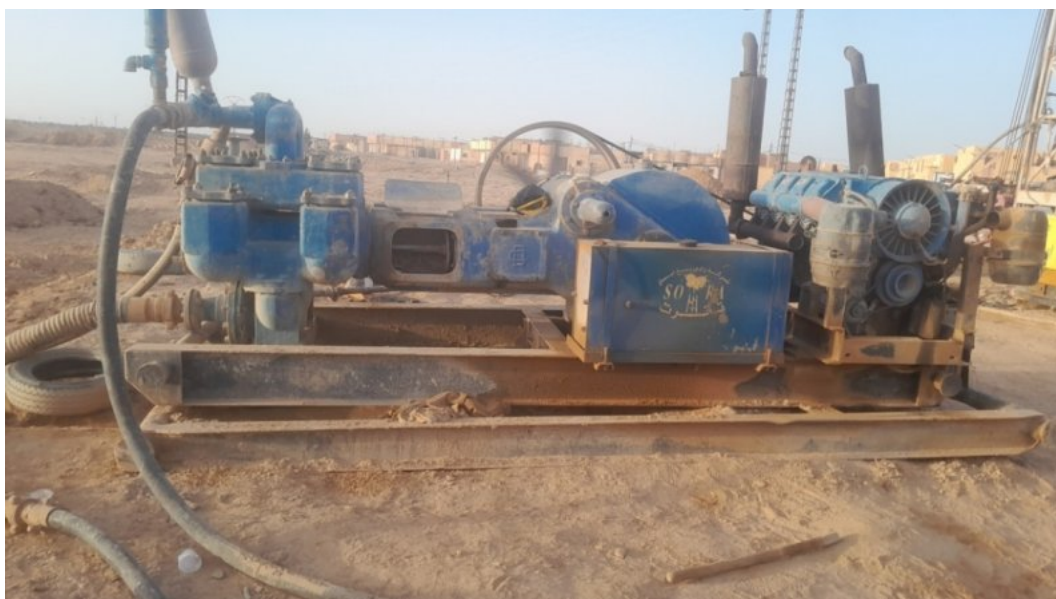
Figure 5 : pompe à boue de forage
