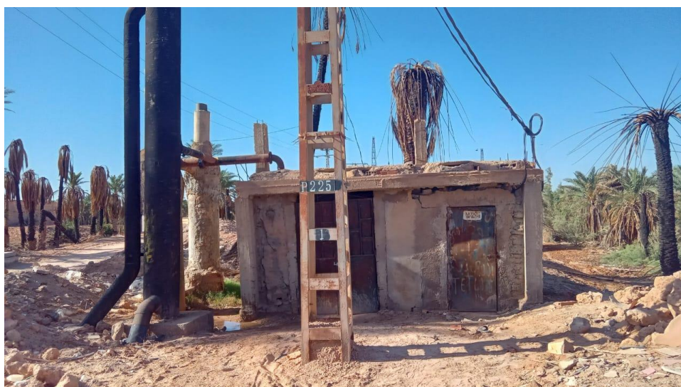
Photo 6. Équipements hydrauliques touchés par les flammes dans la palmeraie
