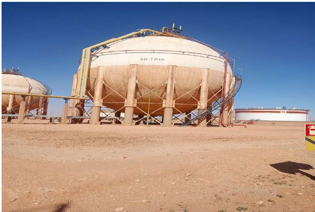
Figure la sphère de stockage GPL (50-T016)
