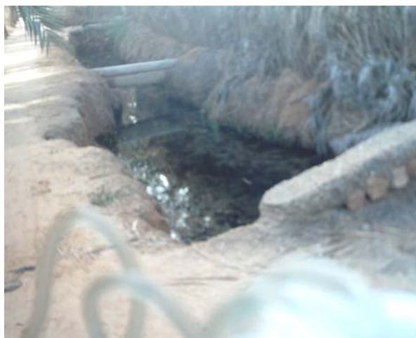
Photo 19. Etat du drain dans la station du Chott.
