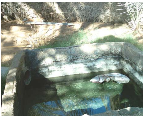
Photo 13. Bassin d'accumulation d'eau dans la station de Mékhadma.
