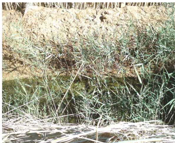
Photo 12. Etat du drain dans la station de Mékhadma.
