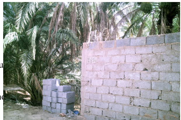
Photo N°4 : Brise vent amélioré "Ancienne exploitation" El Ksar (Tabboucha F ,2006)
