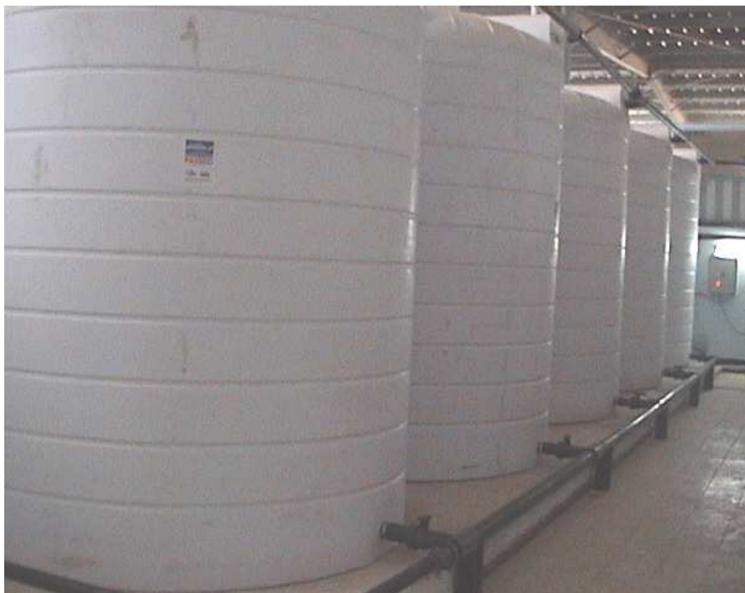
Photo 1 : La disposition des réservoirs.
