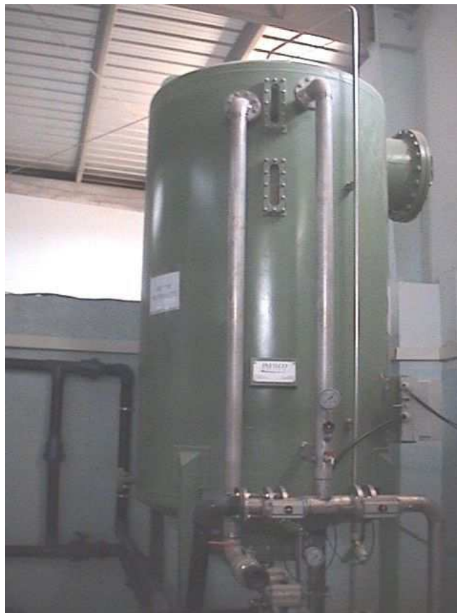
Photo 8: Le filtre à neutralite
