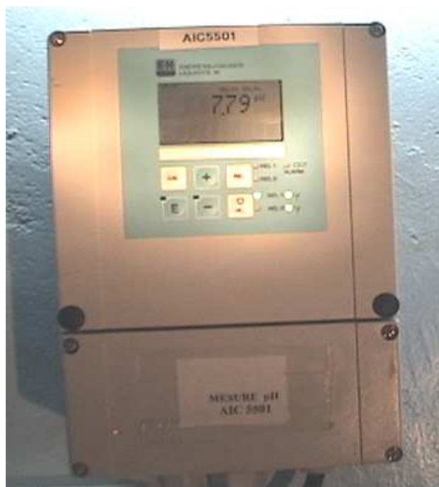
Photo 12 : pH- mètre installé dans le chaîne de traitement
