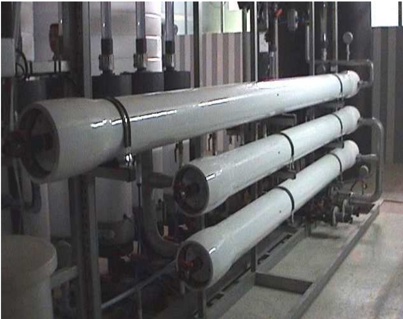
Photo 4 : Les trois modules d'osmose inverse
