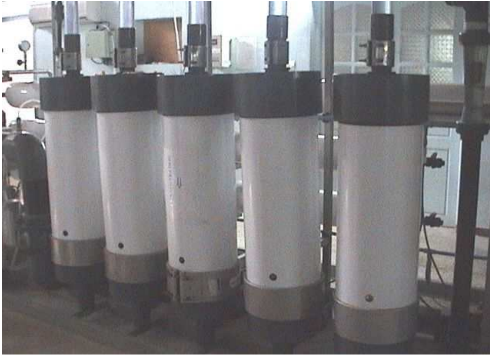
Photo 3 : les cinq cartouches des modules UF 120.
