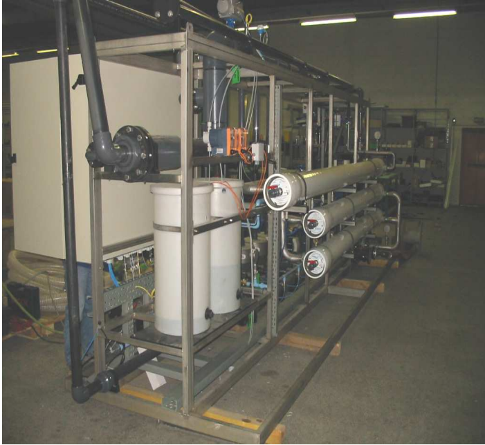
Photo 6 : La dispositif de nettoyage des membranes
