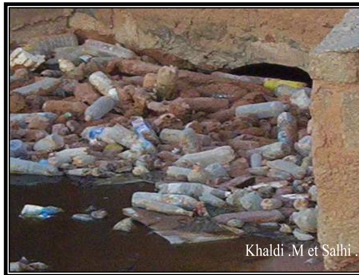
figure N° ( 27): les obstacles par la poubelle qui empêchent l'écoulement d'eau
