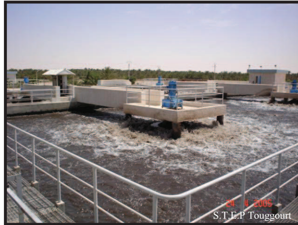
Figure N° 08: Bassin d aération
