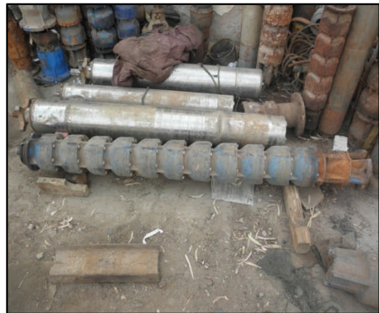
Figure IV.2.d : Différents pompes immergées endommagées par l'abrasion
