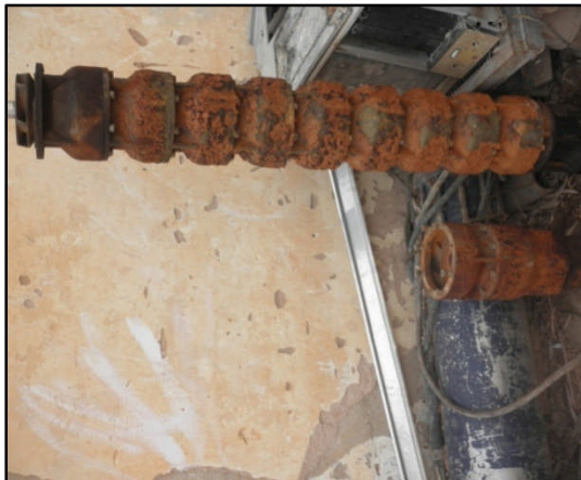
Figure IV.2.i : Pompe immergée multicellulaire endommagée par l'abrasion
