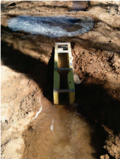
Canal venturi (débit mètre)
