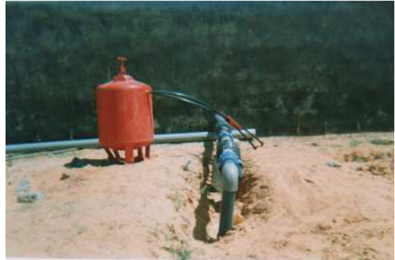
Photo N° 10: Station de tête
