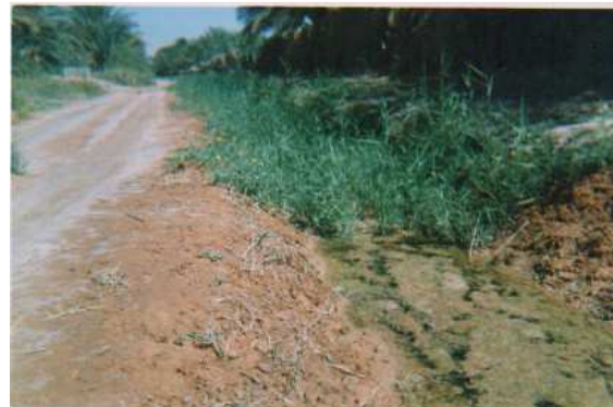
Photo N°13 : Drain avant le nettoyage
