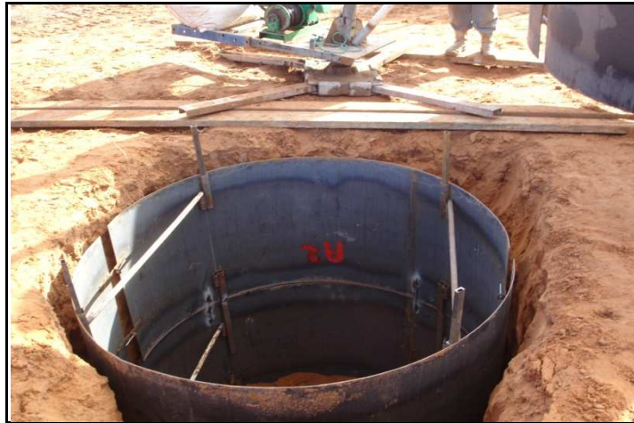
Photo III.02 : Vue d'une buse et son ouverture latérale
