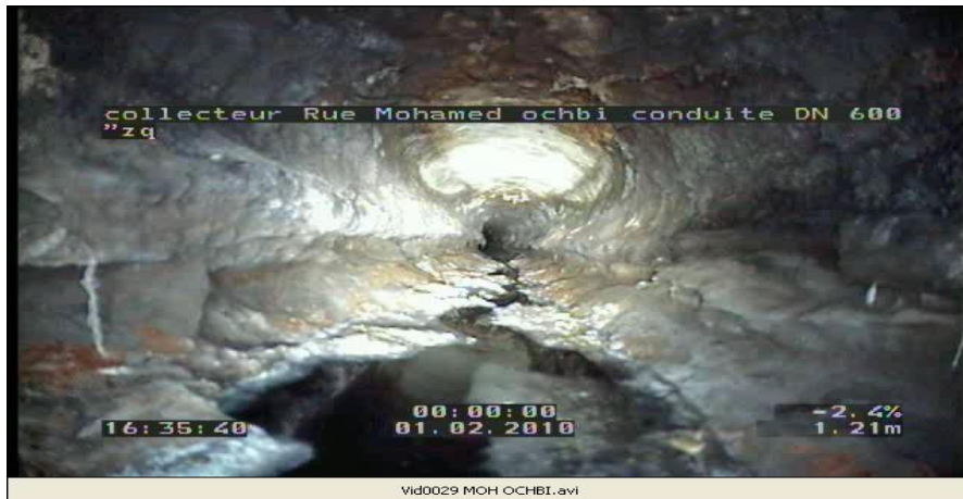
Photo: 28-IV Dégradation des conduites du ville de Touggourt qui présent la corrosion des conduites (pas de partie supérieur)
