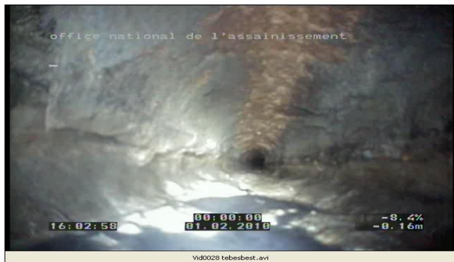
Photo: 27-IV Dégradation des conduites du ville de Touggourt qui montre la dégradation du partie supérieur du conduite
