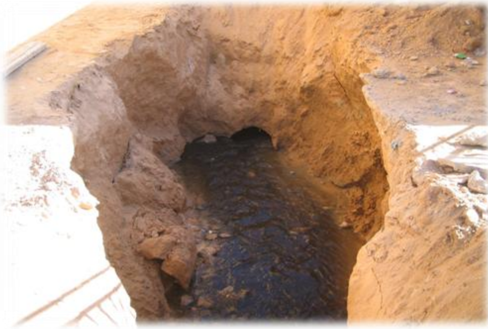
Photo: 12-IV Affaissement de sol cité Ben Traya Lamnaouar
