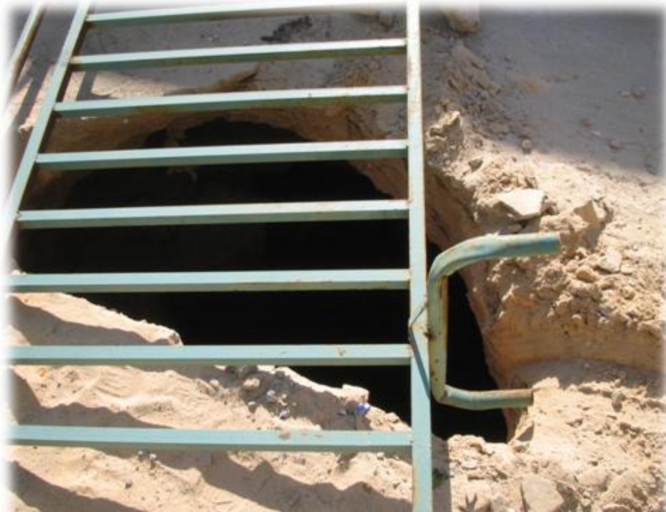
Photo: 14-IV Affaissement de sol à coté de l'école de ben Amar Annaoui
