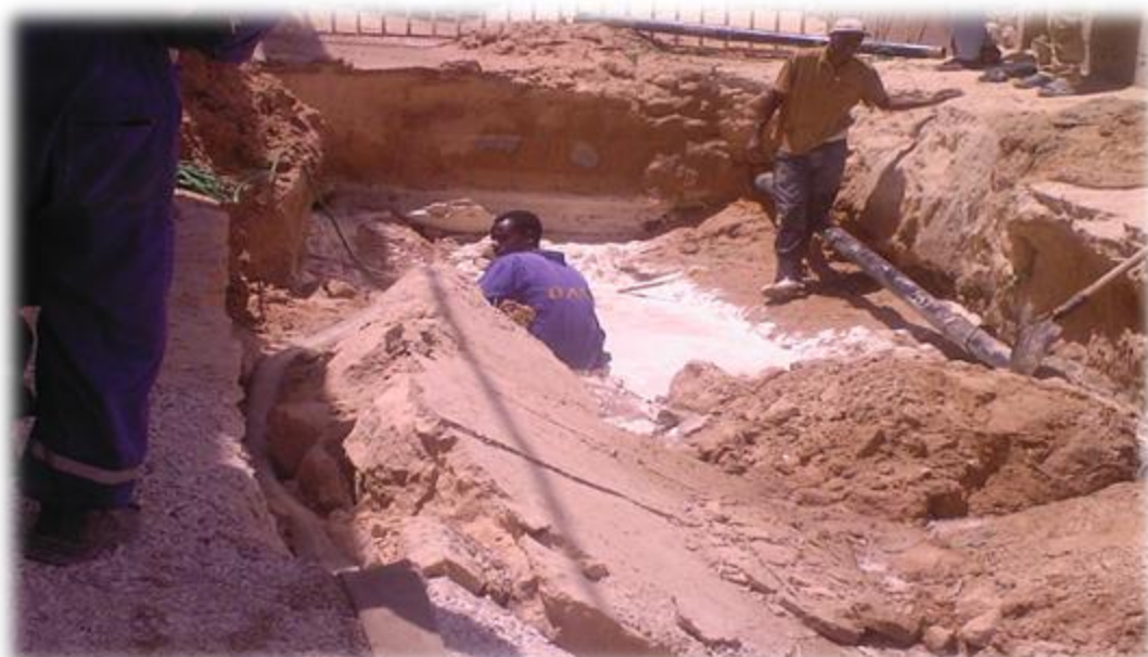
Photo: 18-IV d'affaissement de sol près de Kotlat 165 cité Boumerdes route Sahraoui Alaid Nazla
