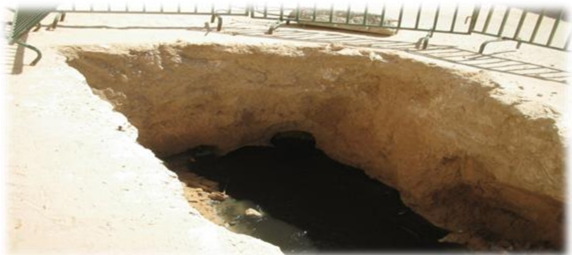
Photo: 13-IV Affaissement de sol cité Ben Traya Lamnaouar
