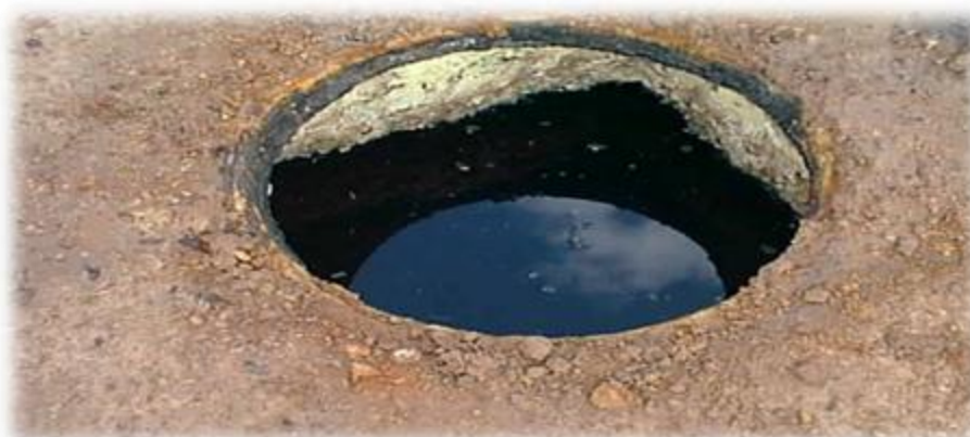
Photo: 25-IV Dégradation des regards du ville Touggourt
