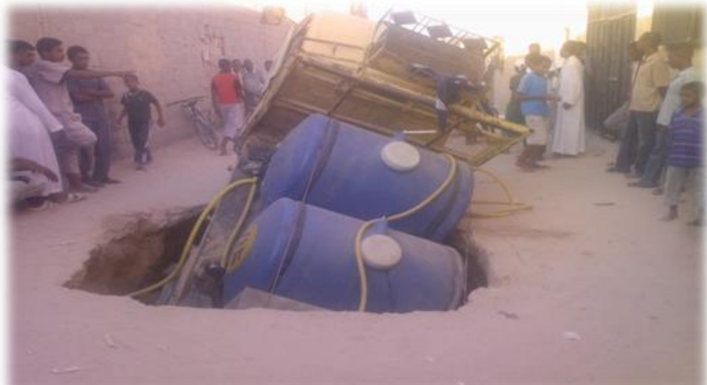
Photo: 16-IV Affaissement de sol près de Kotlat 165 cité Boumerdes route Sahraoui Alaid Nazla
