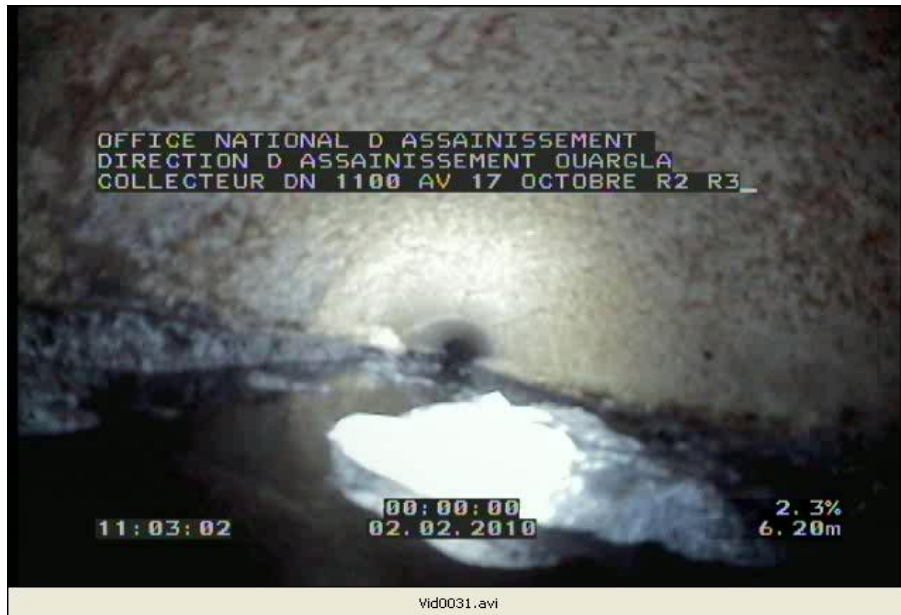
Photo: 30-IV Dégradation de conduite qui montre la précipitation des ettringite
