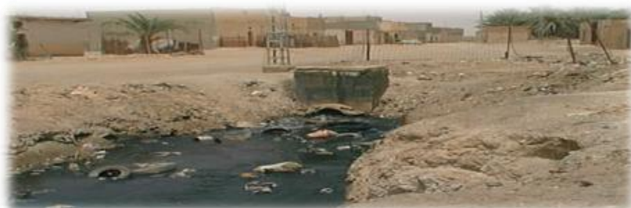
Photo: 24-IV Dégradation des conduites du ville Touggourt
