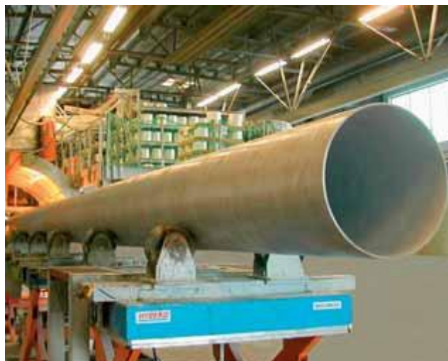
Figure V-3: canalisation de PRV [18]
