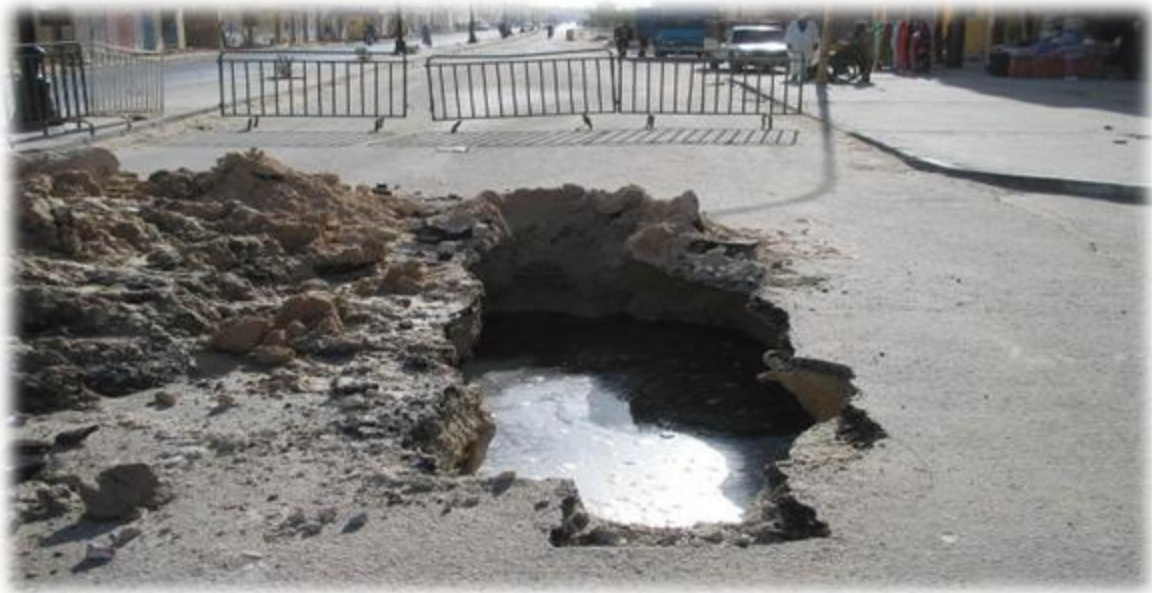
Photo: 8-IV Affaissement de sol route de double position vers Zaouïa Alabidia
