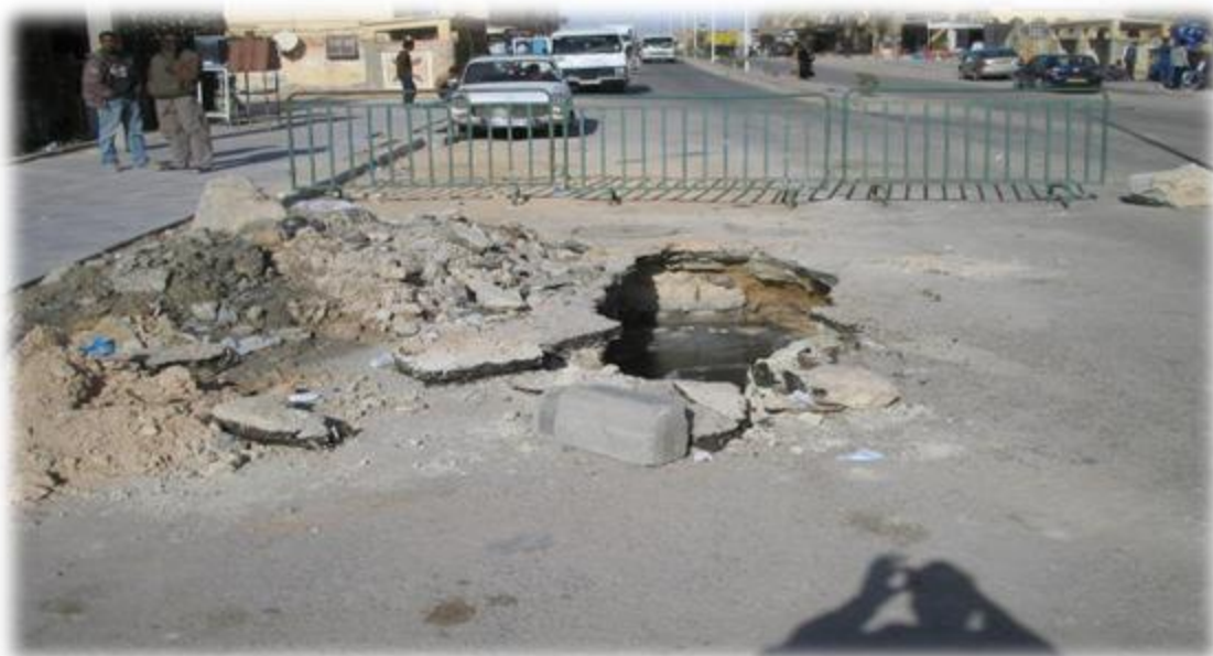
Photo: 9-IV Affaissement de sol route de double position vers Zaouïa Alabidia
