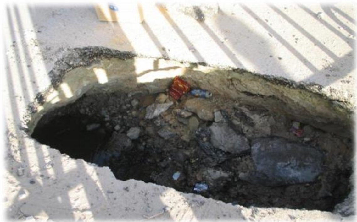
Photo: 3-IV A ffaissement de sol en face du cabine de docteur Ramadhan
