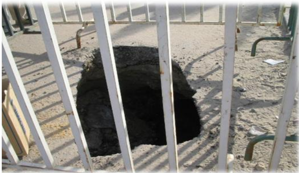
Photo: 4-IV Affaissement de sol en face du cabine de docteur Ramadhan
