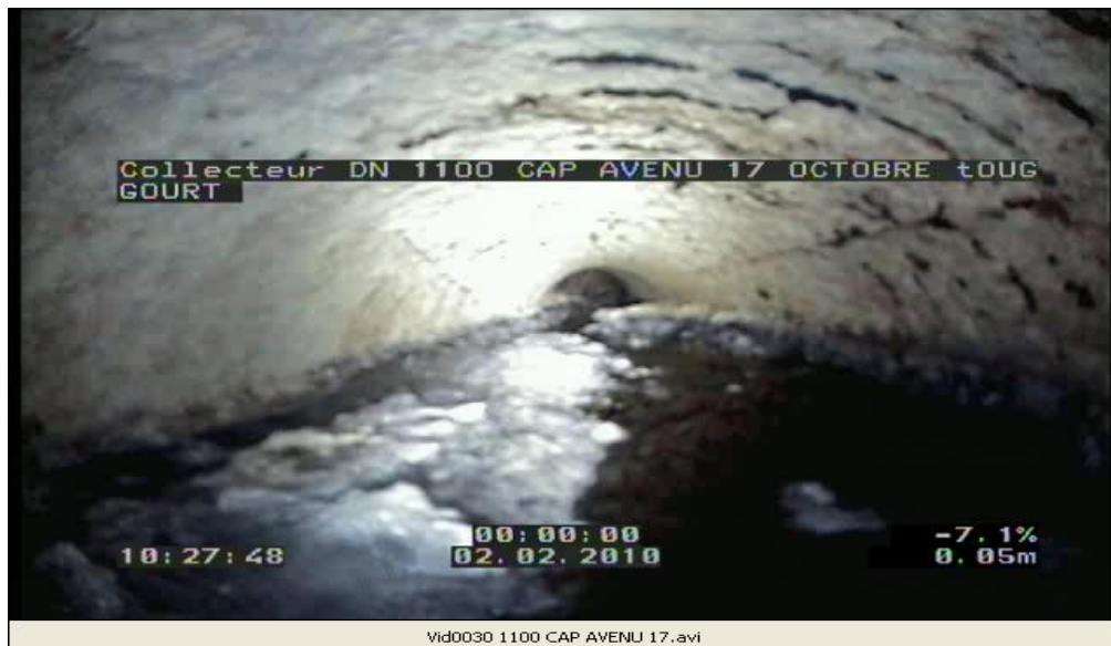
Photo: 29-IV Dégradation des conduites du ville de Touggourt qui montre les armatures (dégradation de l'enrobage)
