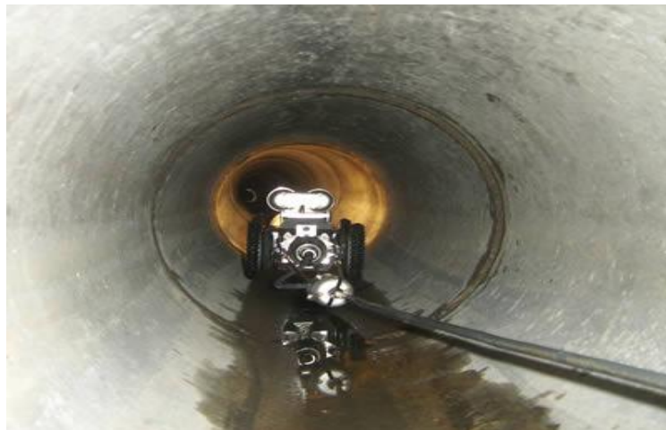
Figure : III-3 Photo de caméra visitable pour les réseaux d'assainissement
