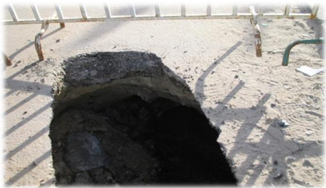
Photo: 2-IV Affaissement de sol en face du cabine de docteur Ramadhan
