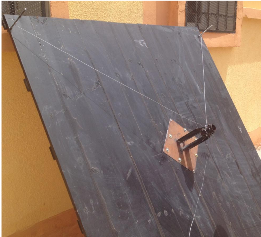
Figure (III-8): Support de cheminée fixé sur la planche en bois ainsi que les tiges filetées
