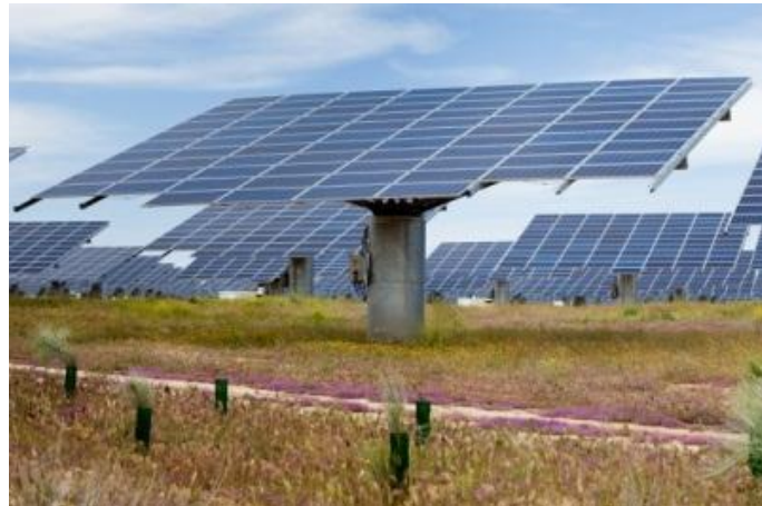
Figure (I-1): Panneaux solaires photovoltaïques.
