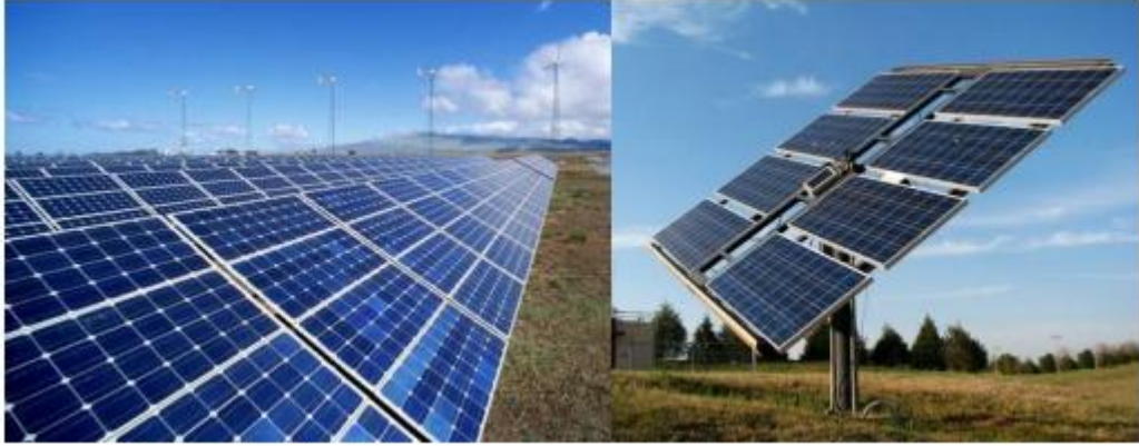
Figure (I.16) : Panneau photovoltaïque.
