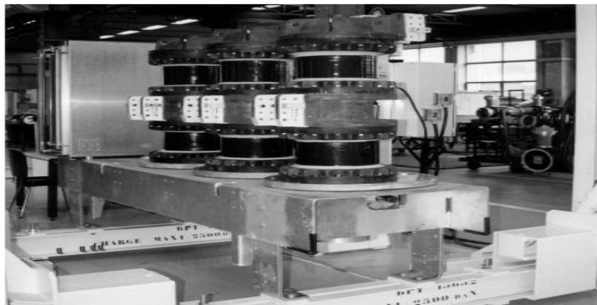
Figure II.7- Disjoncteur gaz SF 6
