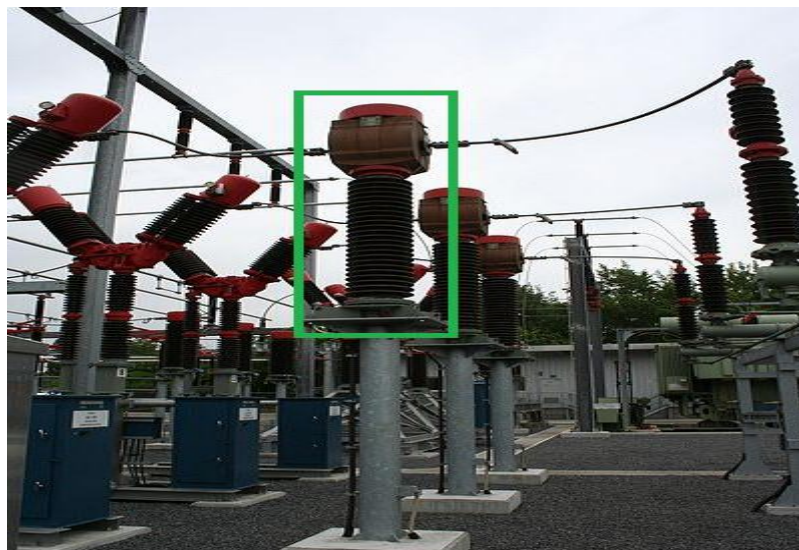
Figure II.10- transformateur de courant
