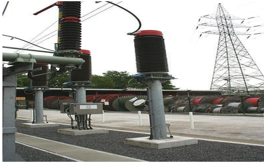
Figure II .9 transformateurs de tension
