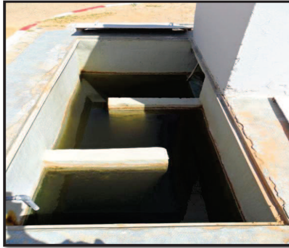
Photo 6 : Bassin de chloration
