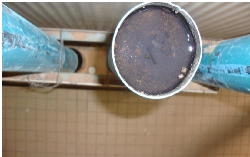
Photo (7) : Le colmatage des filtres
