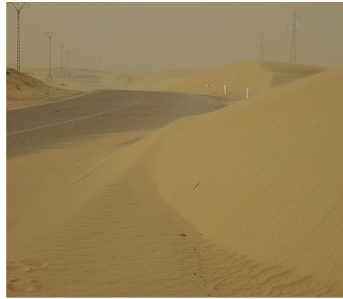
Figure 5 : Photo d'envahissement de la route par du sable, RN16
