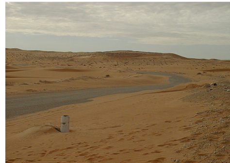
Figure 1 : ensablement partiel de la RN53
