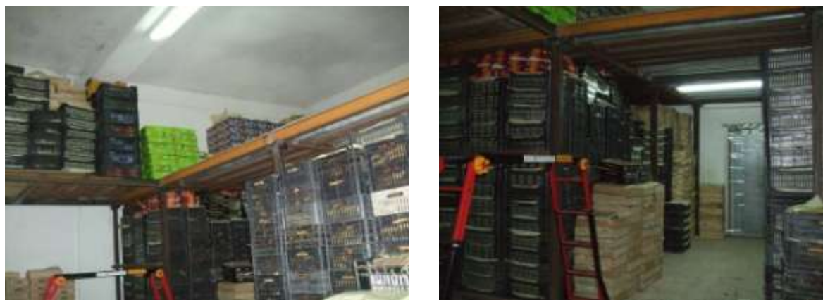
Photo 3 : Intérieur d'une chambre froide
