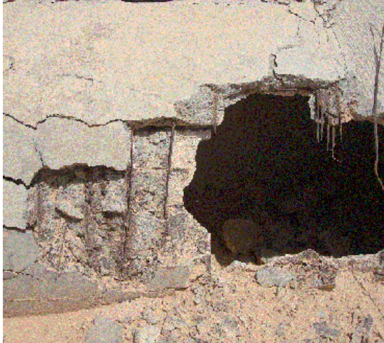
A : Destruction du béton et la corrosion des aciers
