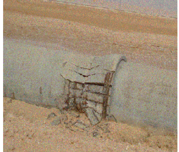
B : Eclatement d'enrobage et la corrosion des aciers
