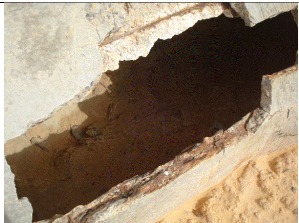
B : Attaque par les sulfates des eaux usées et le gaz H 2 S
