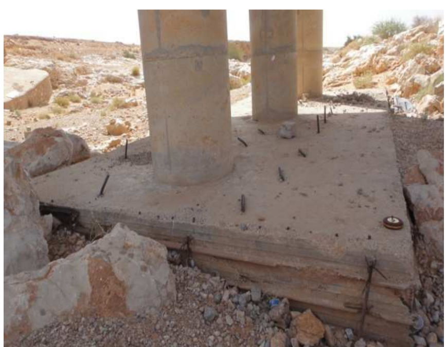
Affouillement au niveau des piles
