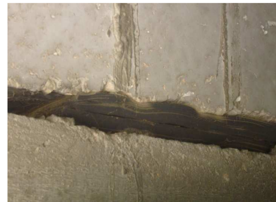
Fatigue des appareils d'appuis
