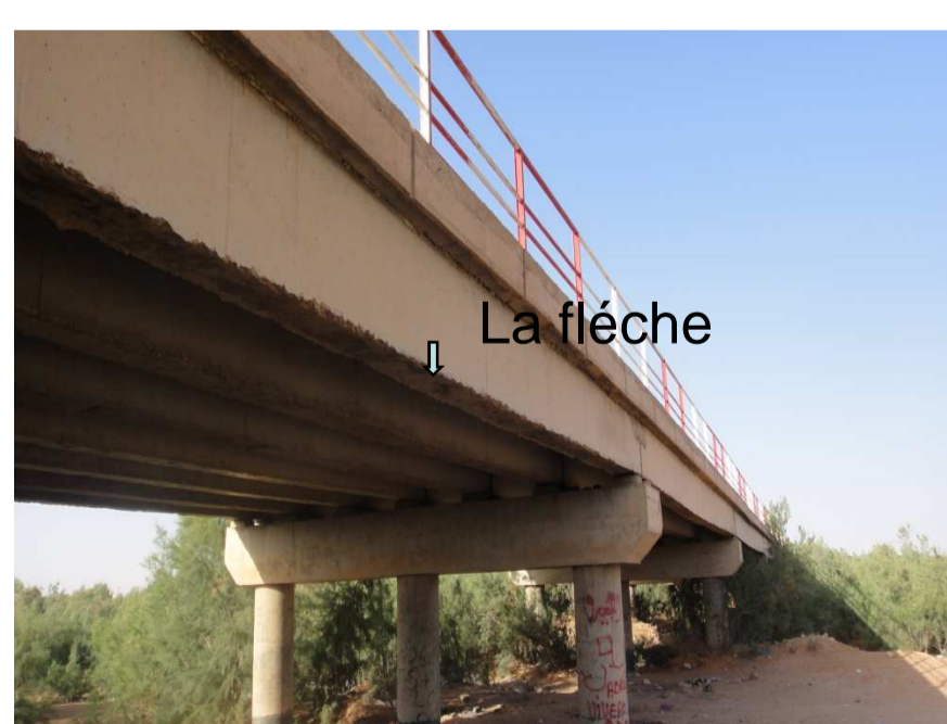
Flèche des poutres
