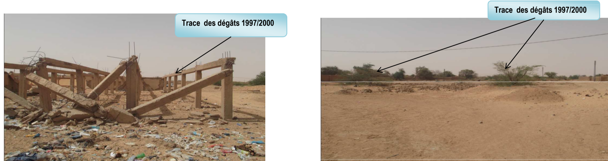
Fig 2 : Trace des dégâts des crues à In-Guezzam
