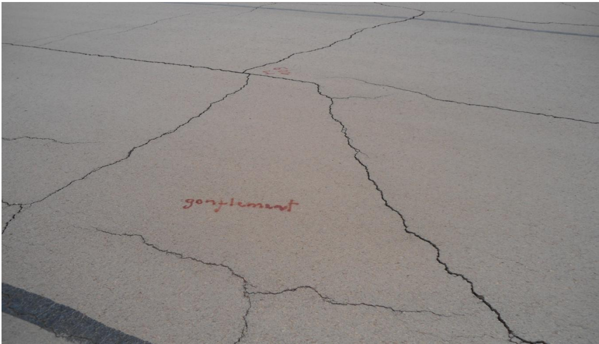
Photos IV-4 : Dégradation de la piste de l'aérodrome d'In Salah sous l'effet de gonflement de l'argile
