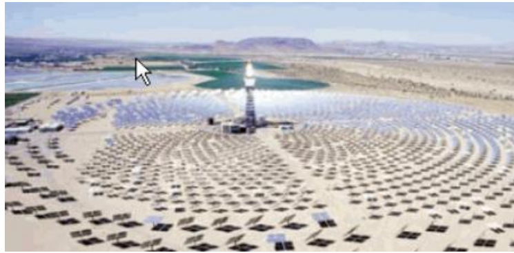
Figure I.10 : Centrale solaire à tour
