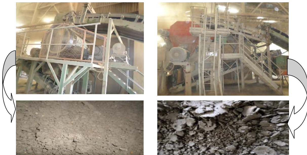
Fig. II.9: Photos représentant la vue générale du Préfinisse (broyeur)(A)et broyeur finisseur(B)[1]
